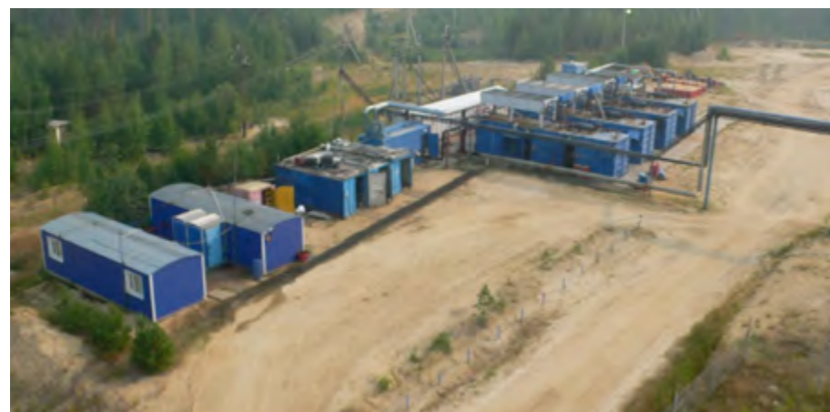
Заказчик ООО «Томская нефть», Соболиное м/р. Мощность энергокомплекса - 4 МВт. Вид сверху.
